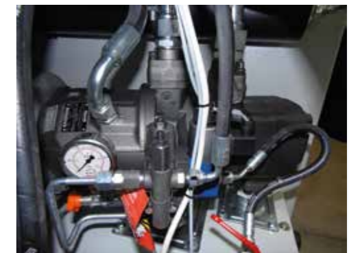
Unidade de controlo hidráulica
