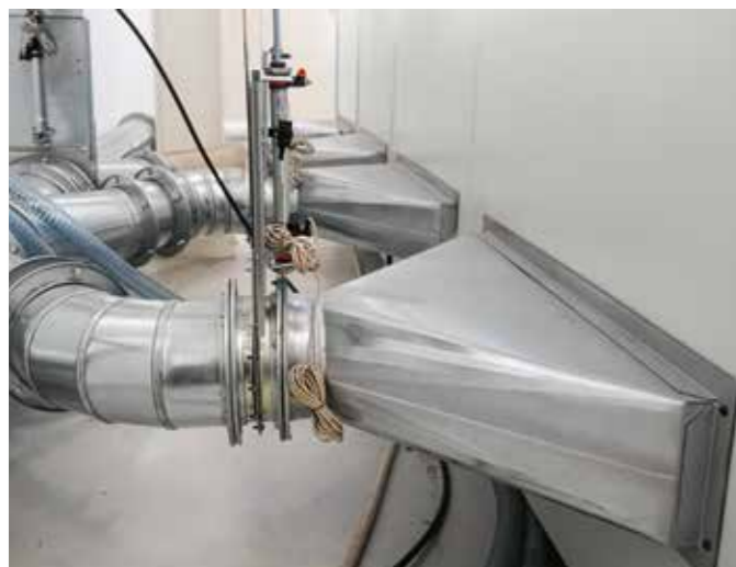
Система пылеудаления для эффективного воздухообмена и пылеподавления в рабочей зоне
