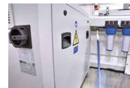
Quadro elettrico integrato al basamento della vasca per ridurre l'ingombro a terra.
