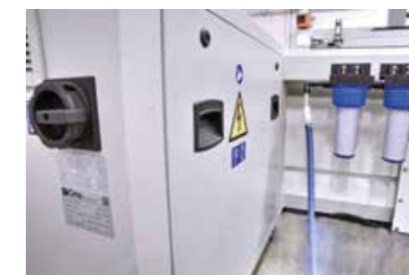
Электрическая панель встроена в основание резервуара для уменьшения занимаемой площади.
