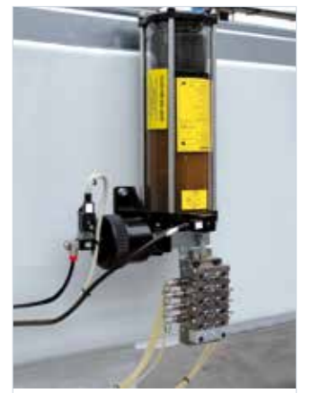
Sistema de lubricación automático.
