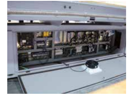
Im Sockel integrierter Schaltschrank
