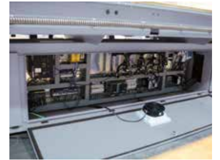
Armoire électrique intégrée au bâti
