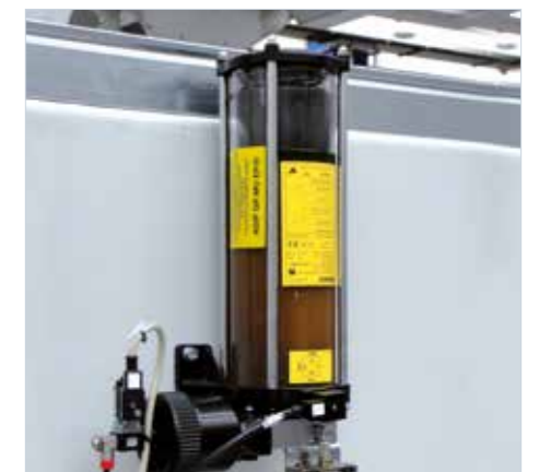
Sistema de lubricación automático.
