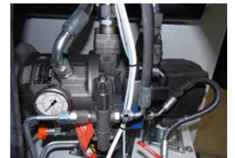
Unidade de controlo hidráulica
